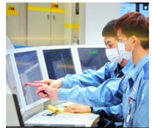
高浜原発 2号機の原子炉を起動する様子
